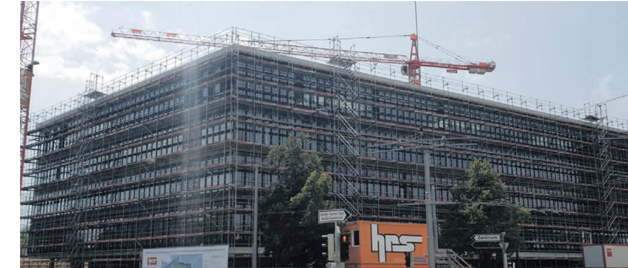
Die Baustelle beim Inselspital in Bern. BIM half bei der Planung des grossen Bauprojekts.
